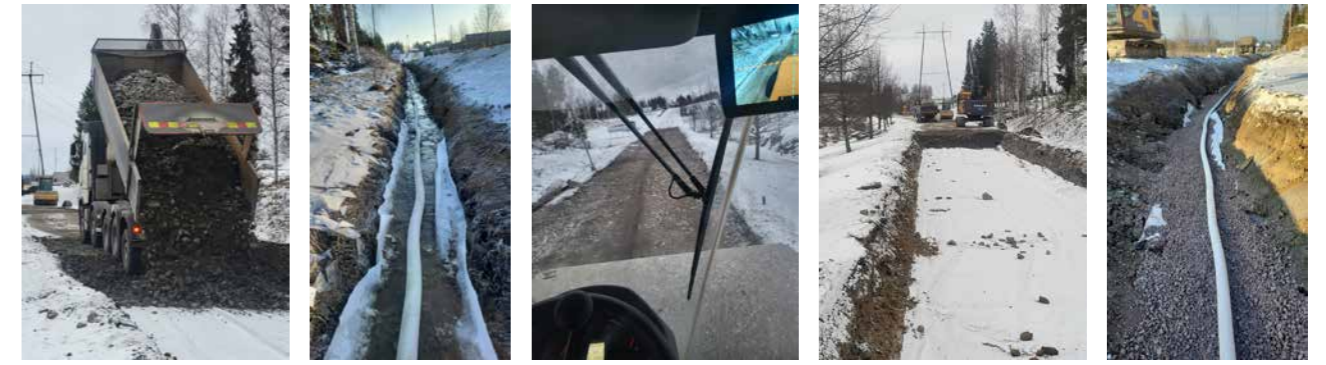
Talvitöinä teimme myös sisääntulotien rakenteelliset parannukset ja löysimme sieltä samalla erään ison korjattavan ongelman, jonka saimme korjattua. Tie saa uuden asfalttipinnan toukokuun aikana.
